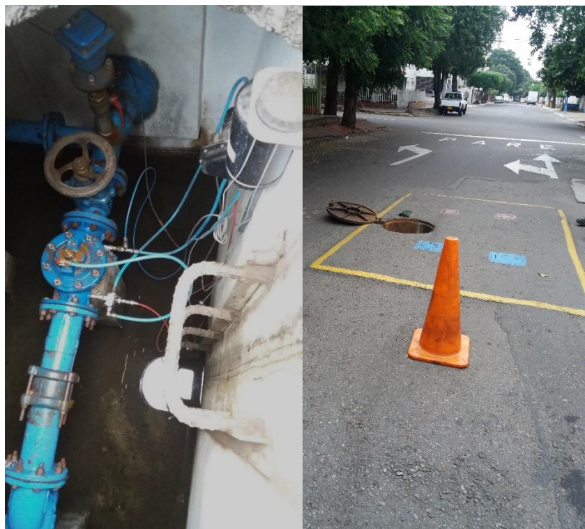
Figura 11. Estaciones reguladores de presión (ERP) por dentro y fuera.
