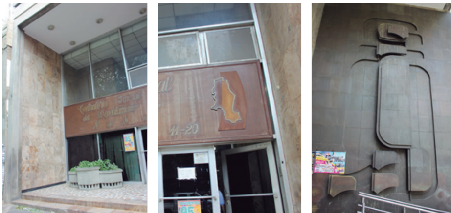
Figura 87. Fotografías del acceso norte del edificio del antiguo Banco de la República
