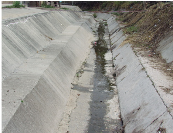
Figura 9. Obstrucción en canal
