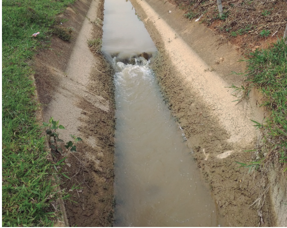
Figura 8. Efecto de la presencia de sedimentos en un canal
