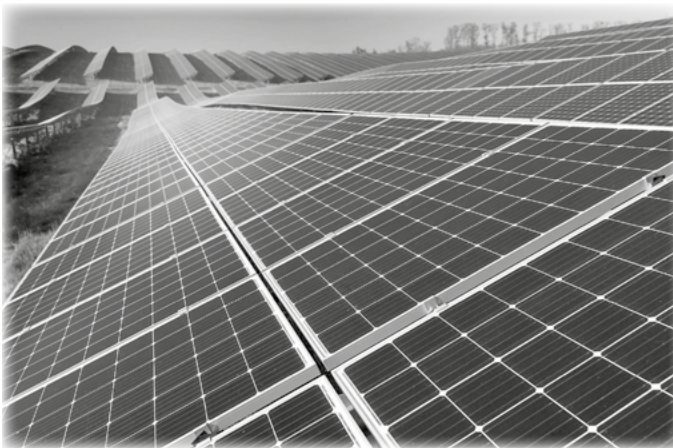
Figura 12. Energía solar fotovoltaica.
