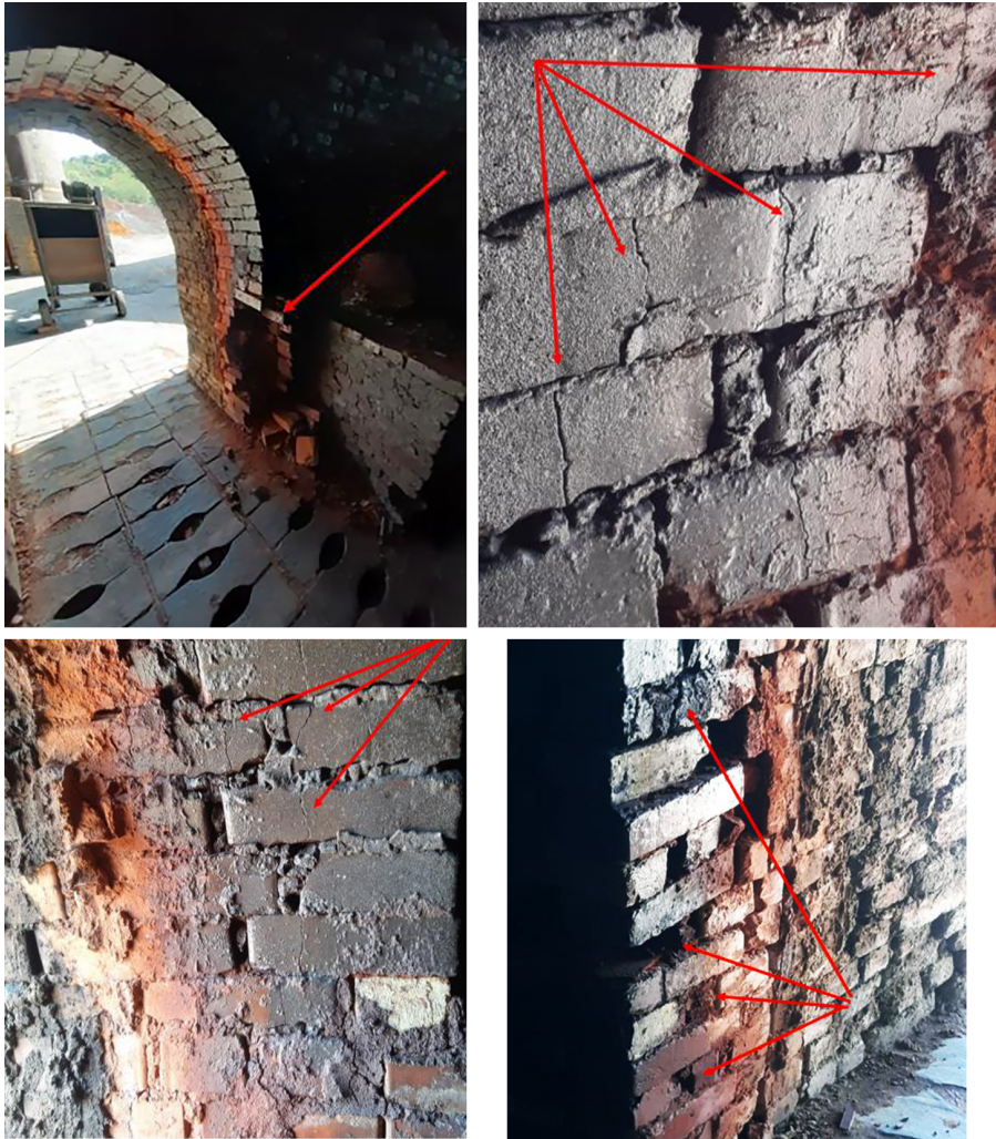
Figura 25. Defectos evidenciados en las puertas del horno colmena
