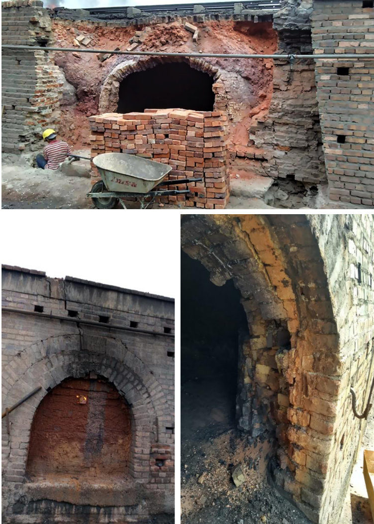
Figura 29. Defectos evidenciados en horno colmena de coquización
