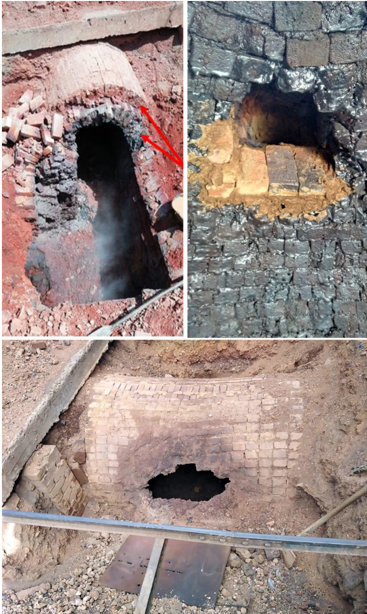
Figura 28. Defectos evidenciados en los ductos de la batería de coquización
