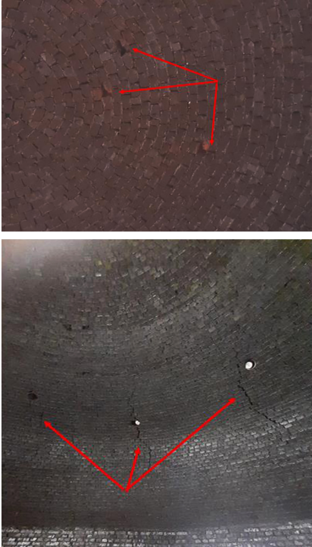
Figura 26. Defectos evidenciados en la cúpula del horno colmena
