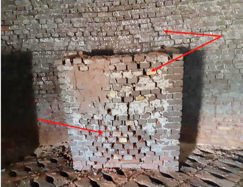
Figura 27. Defectos evidenciados en los sacos de fuego del horno colmena
