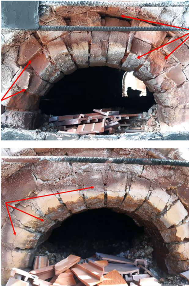
Figura 24. Defectos evidenciados en las hornillas del horno colmena
