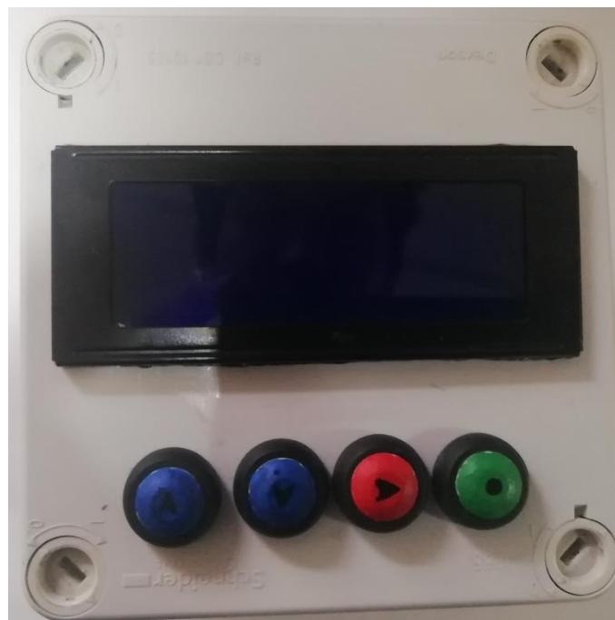
Anexo 6. Módulo de control.
