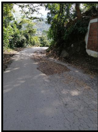
Figura 5. Carpeta asfáltica y base granular en mal estado
