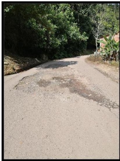
Figura 6. Carpeta asfáltica y base granular en mal estado
