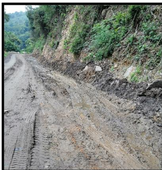
Figura 97. Filtración de agua en la vía
