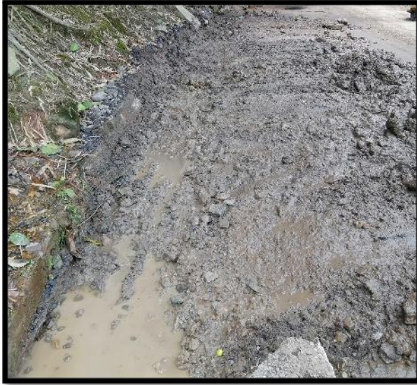
Figura 98. Filtración de agua en la vía
