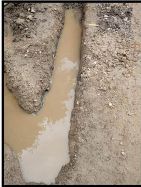
Figura 104. Agua filtrada en la excavación
