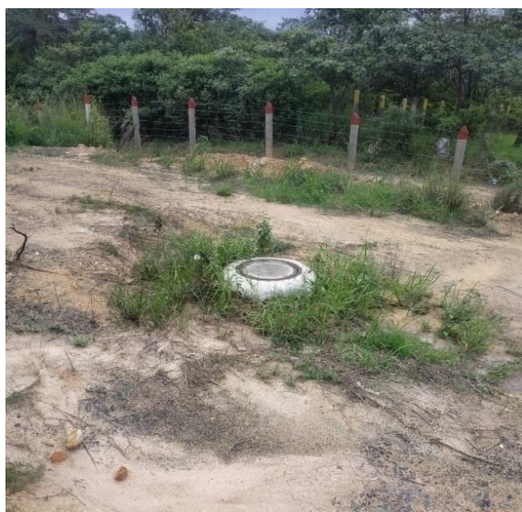
Figura 23. Red de alcantarillado en la zona de trabajo.
