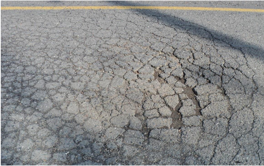
Daño piel de cocodrilo
