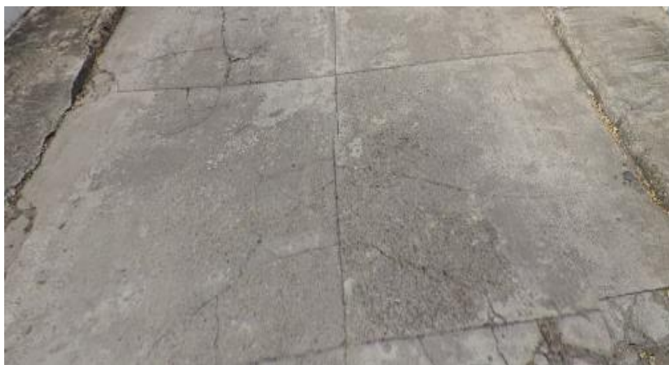
Fisuras pavimento rígido
