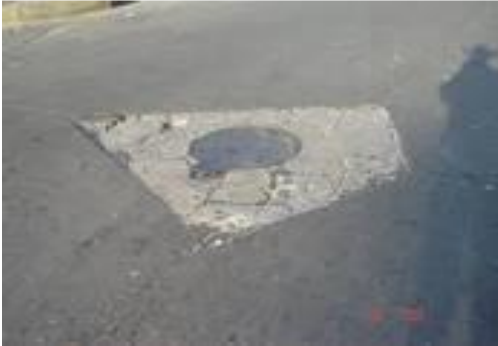
Separación para colocación de tapa de alcantarilla
