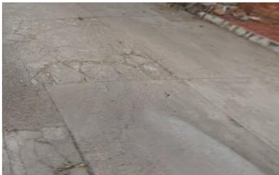
Fisuras pavimento rígido
