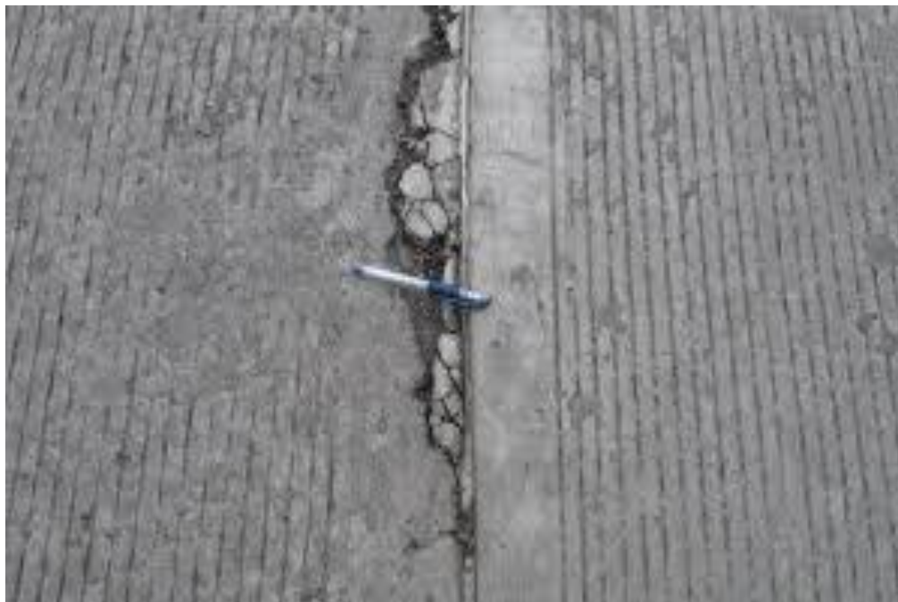
Falla por separación de juntas
