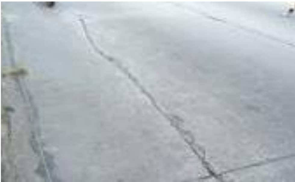
Agrietamiento pavimento rígido
