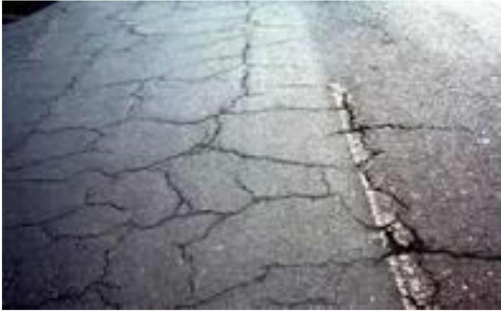
Piel de cocodrilo pavimento flexible
