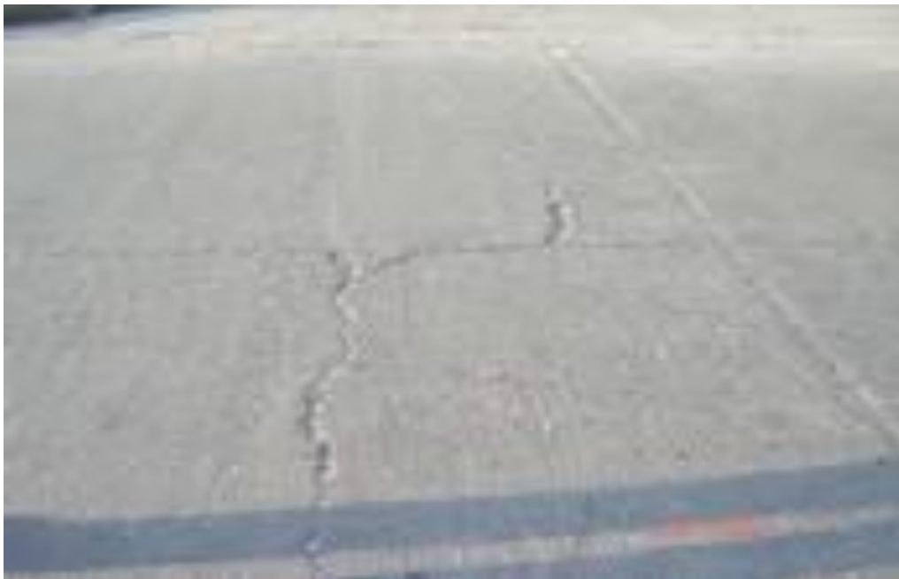
Daño superficial pavimento rígido
