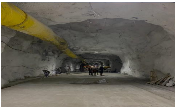
Figura 49. Iluminación deficiente de un túnel con lámparas estacionarias
