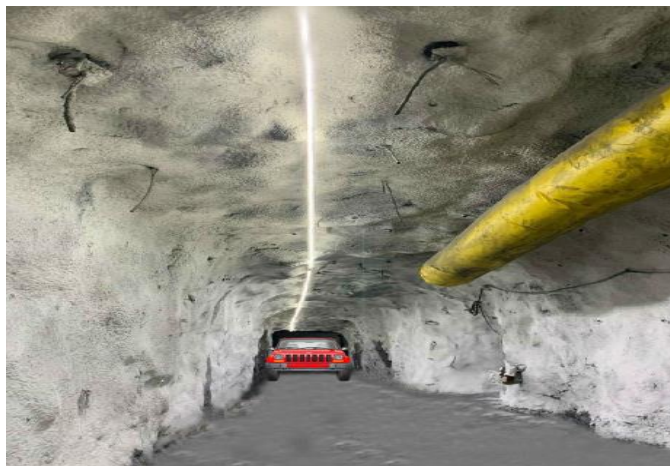
Figura 50. Iluminación eficiente de un túnel con cinta Led
