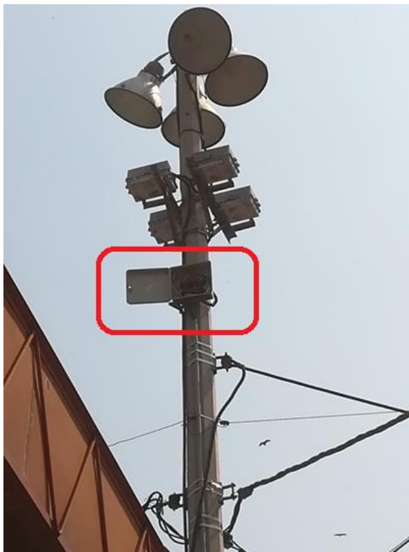
Figura 11. Gabinete sin protección contra abertura.
