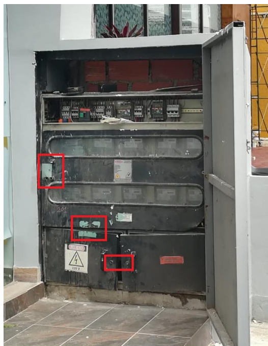
Figura 21. Gabinete 1T08020 ubicado en el barrio Tasajero.
