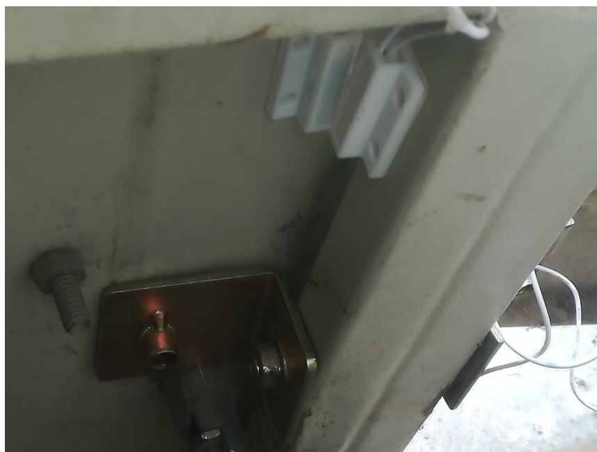
Figura 23. Sensores magnéticos instalados.
