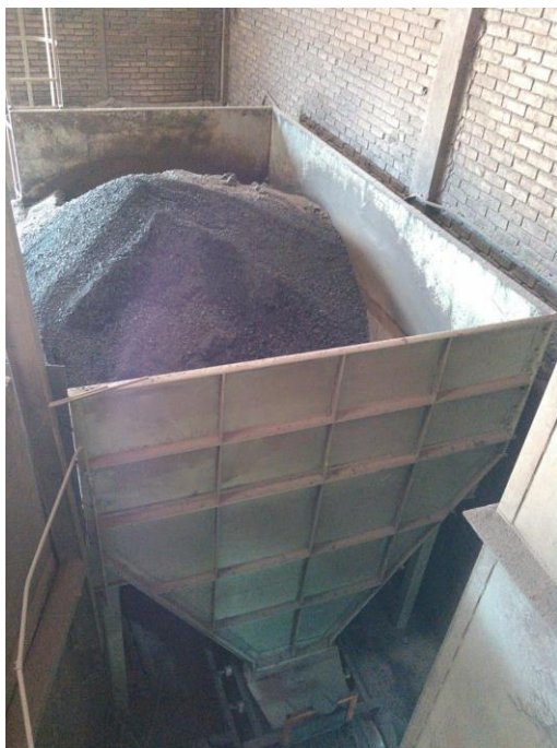
Figura 10 Tolva de alimentación del sistema combustor lecho fluidizado
