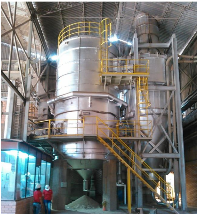
Figura 9 Sistema combustor lecho fluidizado
