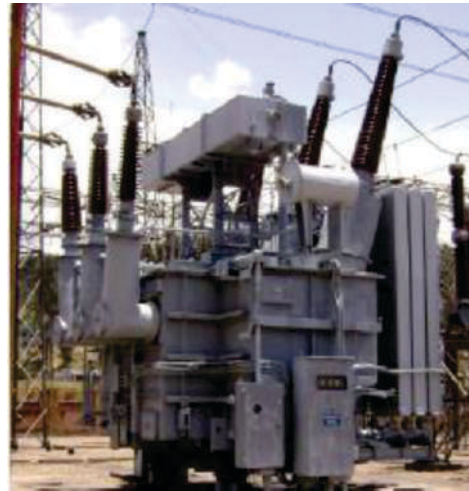
Figura 3. Transformador de potencia 230/115 kV.
