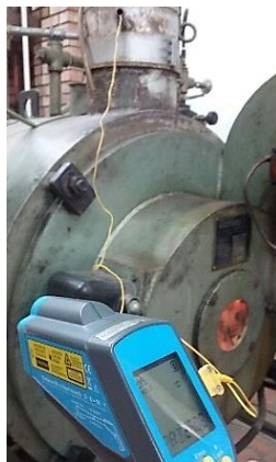
Fig. 5. Toma de datos experimentales, caldera 10 BHP. Fuente. Elaboración propia.
