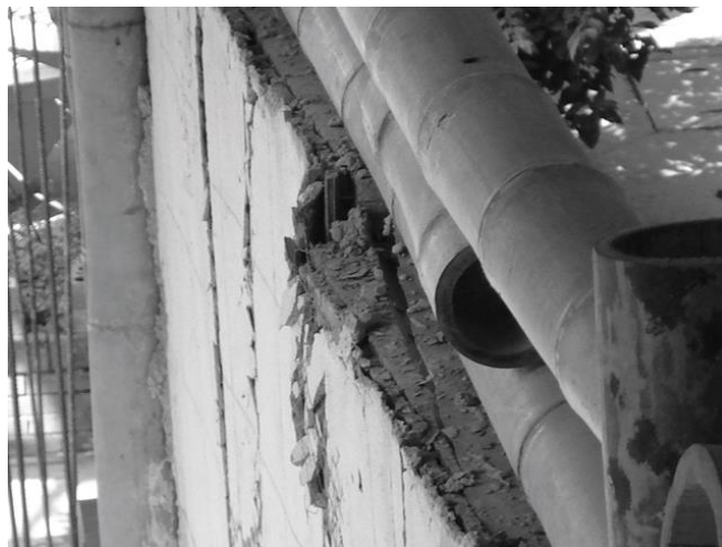
Fotografía 28. Falla en la solera. Herrera y Takeuchi (2009).
