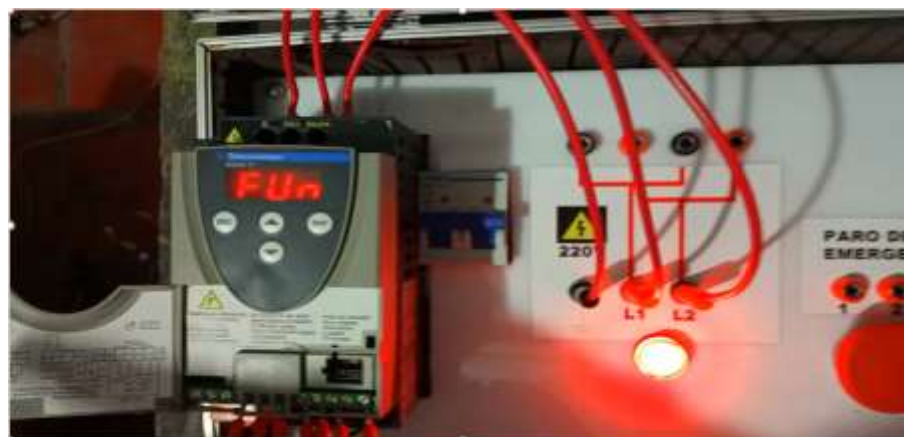
Figura 37. Programación del variador
