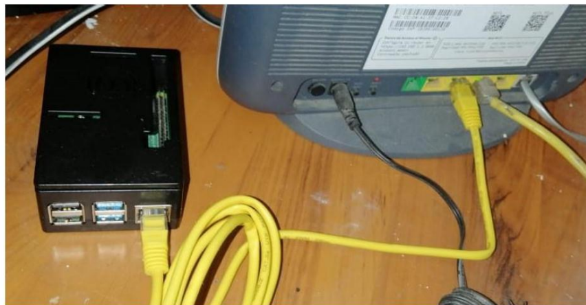
Fig1. Conexión del cable Ethernet de la RASPBERRY PI y el Router.
