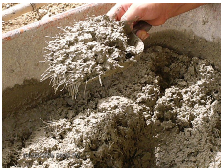
Figura 49. Concreto fresco reforzado con fibras de acero
